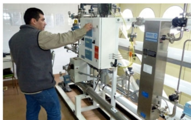
CONTROLES DE LA PLANTA DE AGUA
