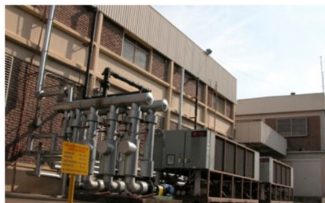
EQUIPOS DE REFRIGERACIÓN
