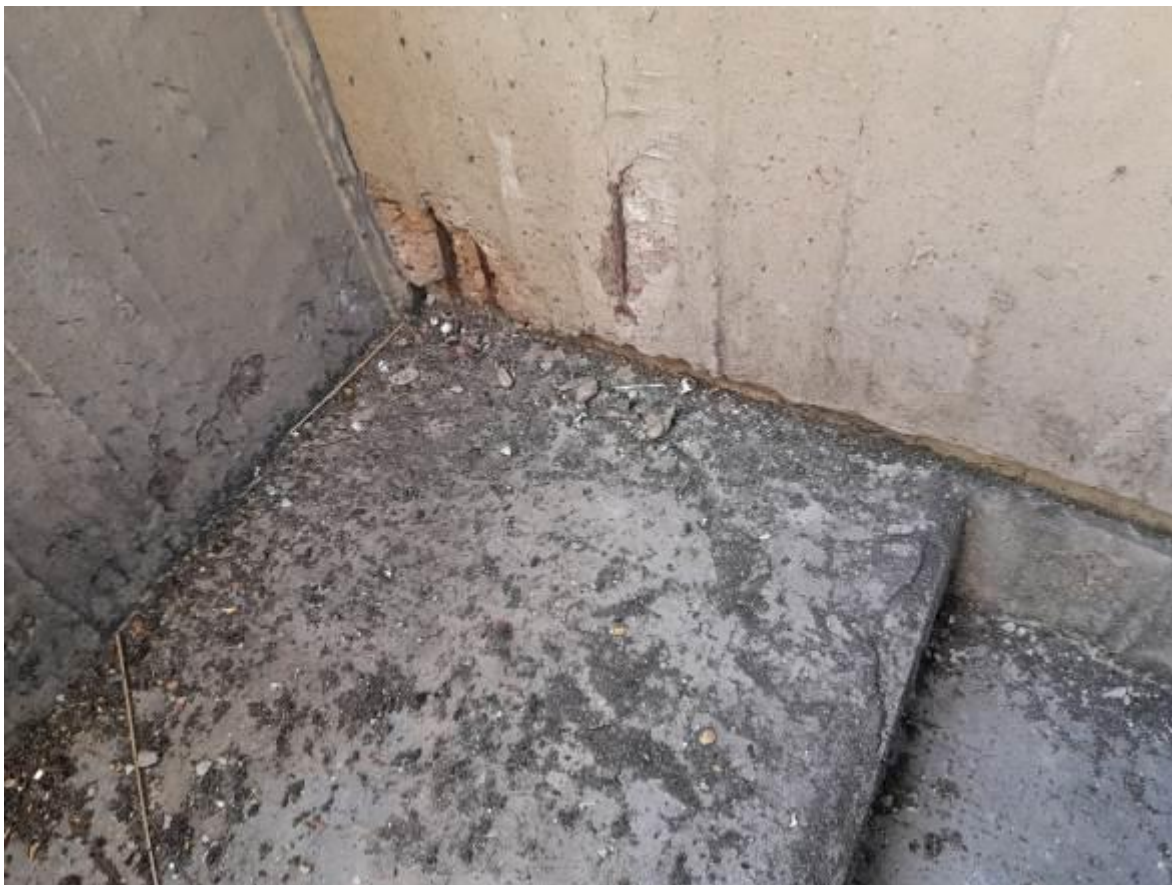
BAJO TANQUE DE BOMBEO
