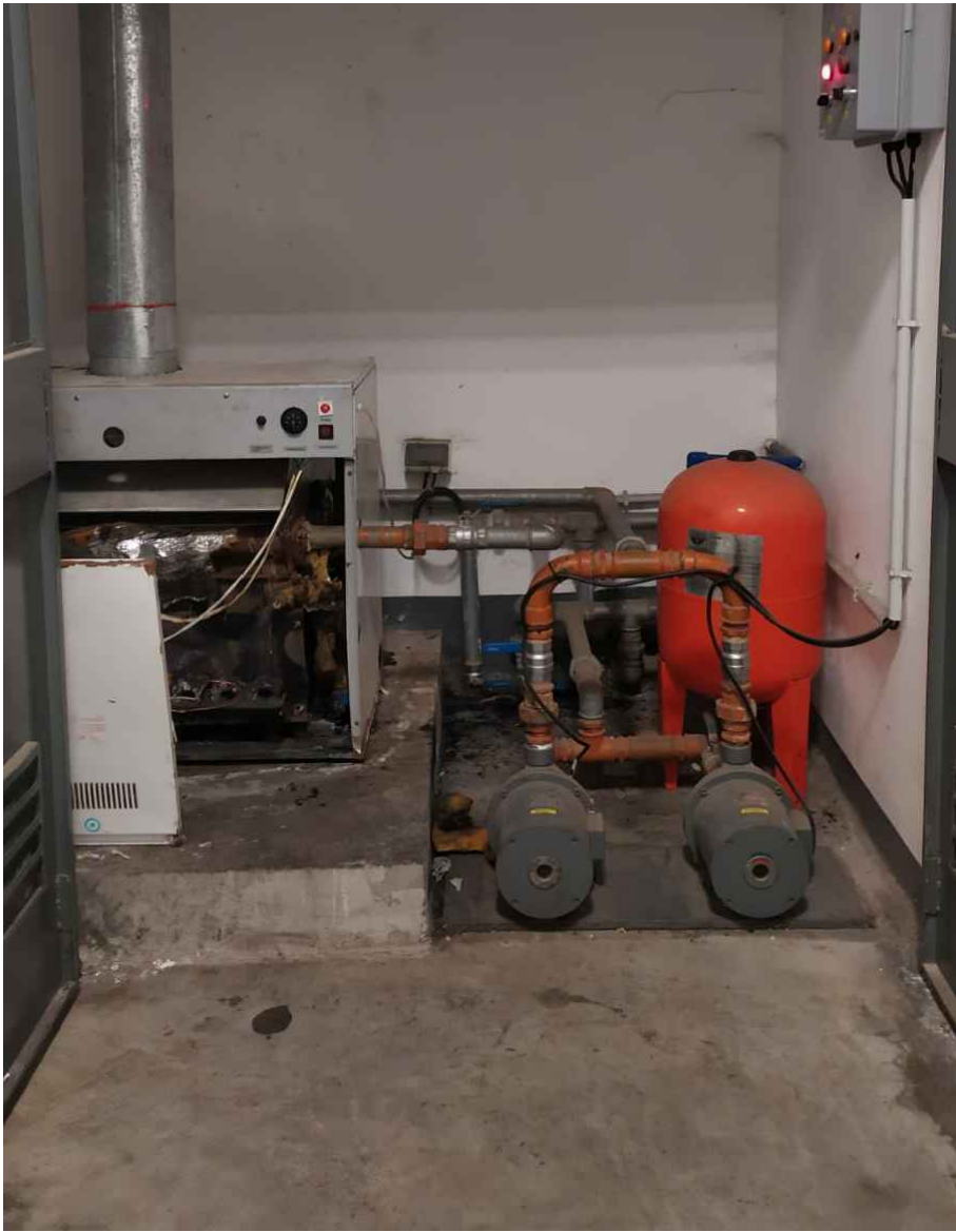
Imagen 4 - Equipos existentes en sala de caldera
