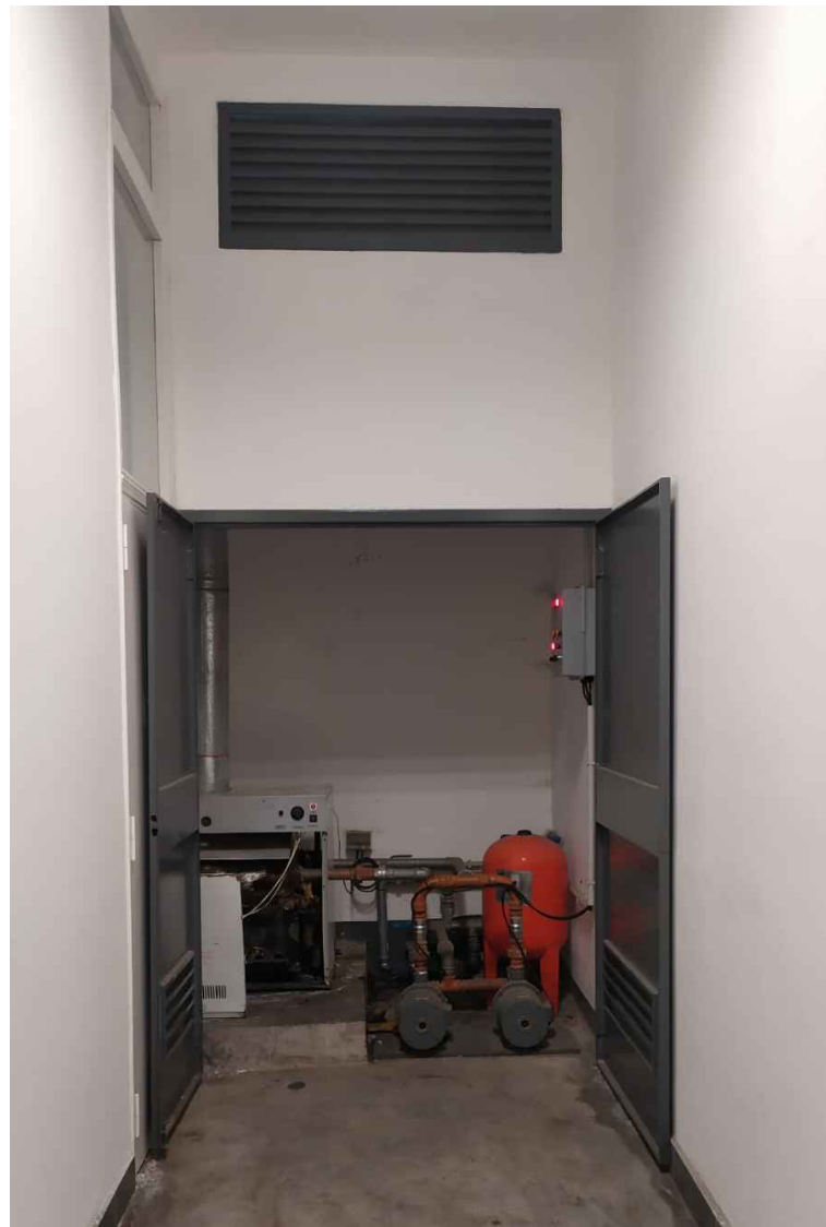
Imagen 1 - Sala de Caldera sector informática
