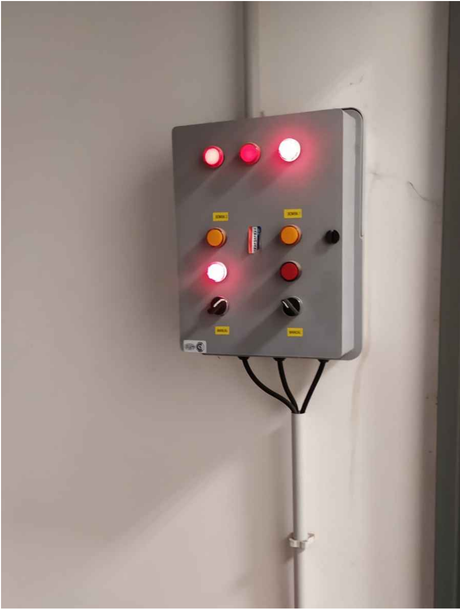
Imagen 6 - Tablero seccional de bombas centrífugas
