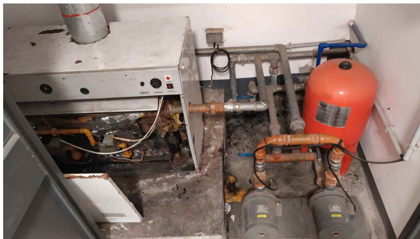
Imagen 2 - Sala de Caldera sector informática
