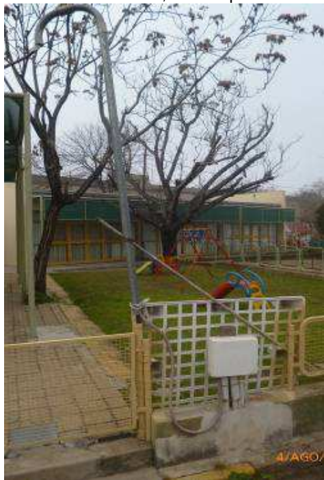
Caño para cable de alimentación
